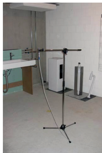
Illustration 4: Installation de mesure au rez-de-chaussée
