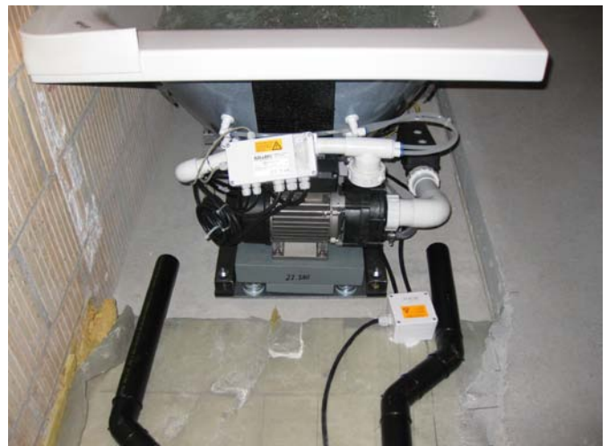
Abb. 2: Ansicht der Pumpe
